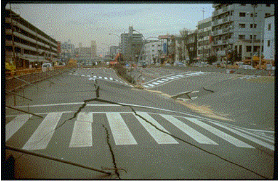
شکل ۱. نشست خیابان در اثر ریزش سقف مترو در زلزله کوبه ژاپن (برگرفته از سایت مترو ژاپن)
