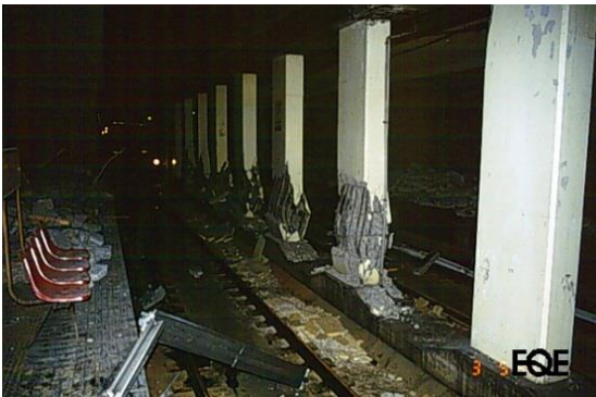
شکل ۲. آسیب وارده به ستون‌های مترو در زلزله کوبه ژاپن (برگرفته از سایت مترو ژاپن)
